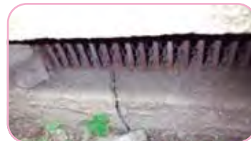
基礎のひび割れを調査
